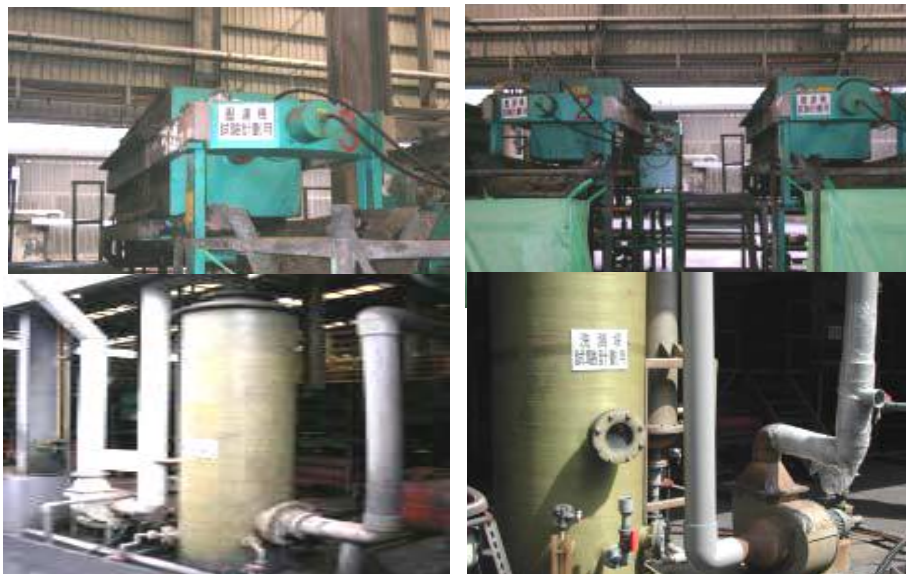
污水處理設備
