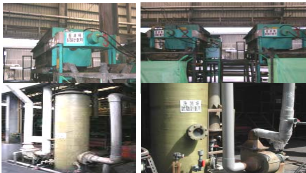
污水處理設備
